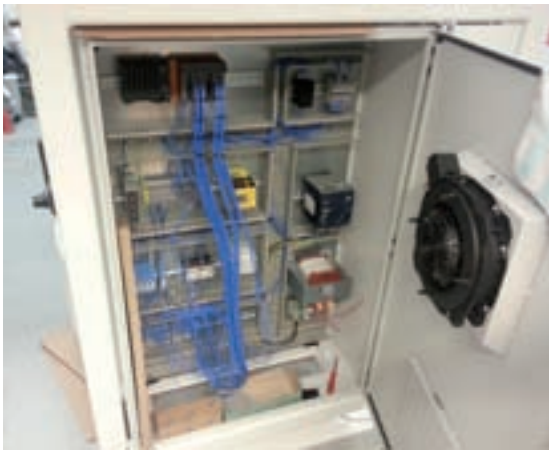
Figuur 6: Bedrading van het laagspanningsgedeelte in de besturingskast; linksboven is de PLC zichtbaar.
